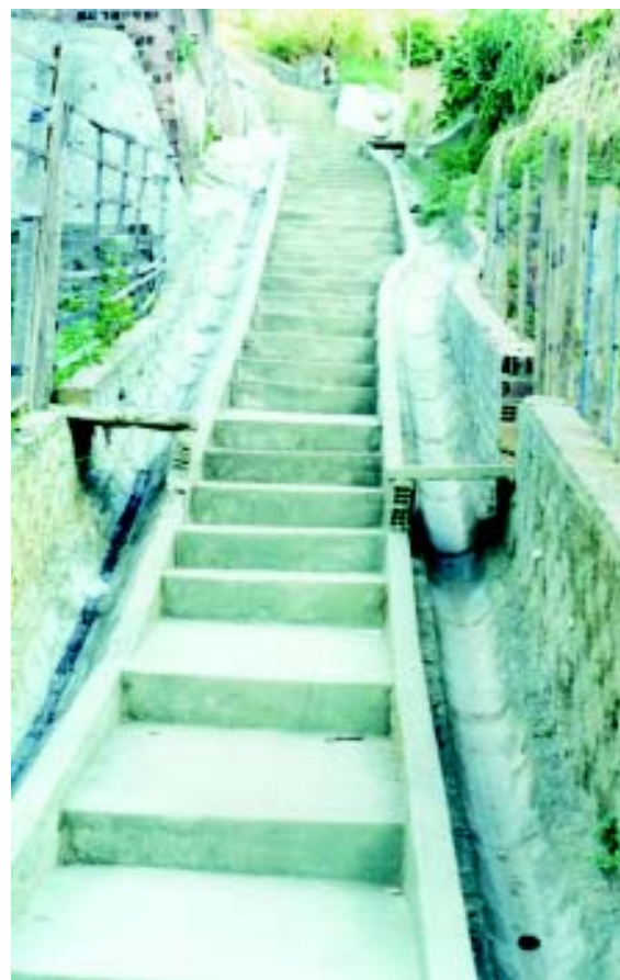
CANALETA de DRENAGEM ACOPLADA à ESCADARIA Córrego do Boleiro, Recife
