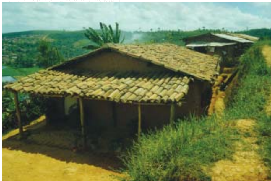
CASA sem BIQUEIRAS e sem SOLUÇÃO de DRENAGEM Alto da Estrela, Moreno
