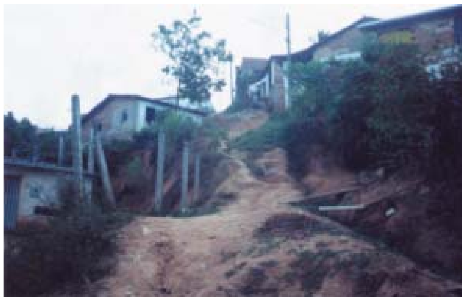
SITUAÇÃO CARACTERÍSTICA de DRENAGEM INDEFINIDA na ENCOSTA Bolo de Noiva - Buriti, Recife
