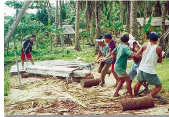
Grupos de voluntarios moldean y arrastran manualmente travesaños de hormigón para un dique marítimo.
