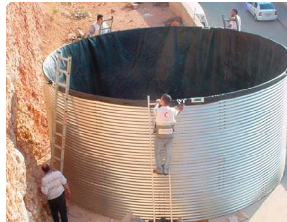
Un equipo de desastres y voluntarios de la Media Luna Roja Palestina instalando un depósito plegable en Nablús.
