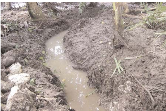
Voluntarios de Radevasu, en la provincia de Malaita, trabajan juntos en la construcción de una red de drenaje (foto superior). En la foto inferior se observan los resultados de su labor.
