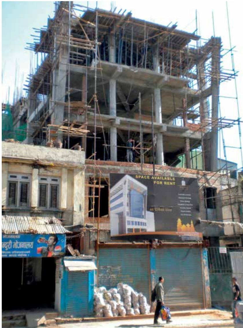
El rápido desarrollo urbano en Katmandú, Nepal, se está gestando en su mayoría sin permisos, a pesar de la existencia de códigos de construcción relevantes.
