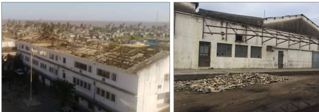
Figura 1 – Telhados de fibrocimento danificados em edifícios públicos e comerciais na cidade da Beira
