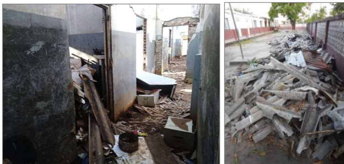
Figura 2 – Escombros de fibrocimento no hospital distrital de Buzi (esquerda) e na cidade da Beira (direita)
