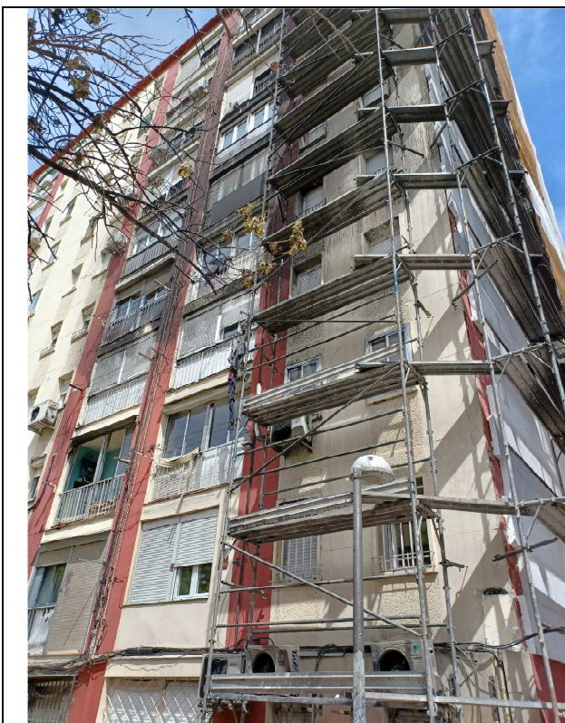
Ilustración 31: Fachada sur del edificio de la calle Godella (San Cristobal, Madrid) afectada por el incendio
